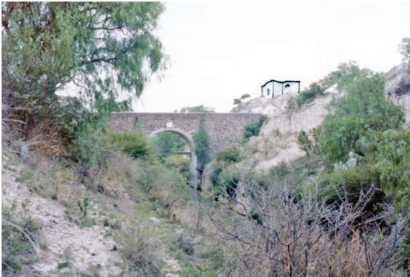
Tajo de Nochistongo, puente El Nopal. Arriba, a la derecha, la caseta de aforo.
